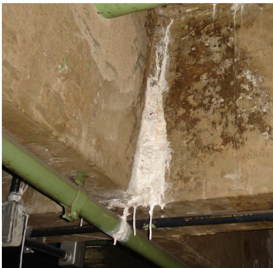
Figura 2.36 – Foto: Eflorescência em encontro de vigas em pavimento de garagem
