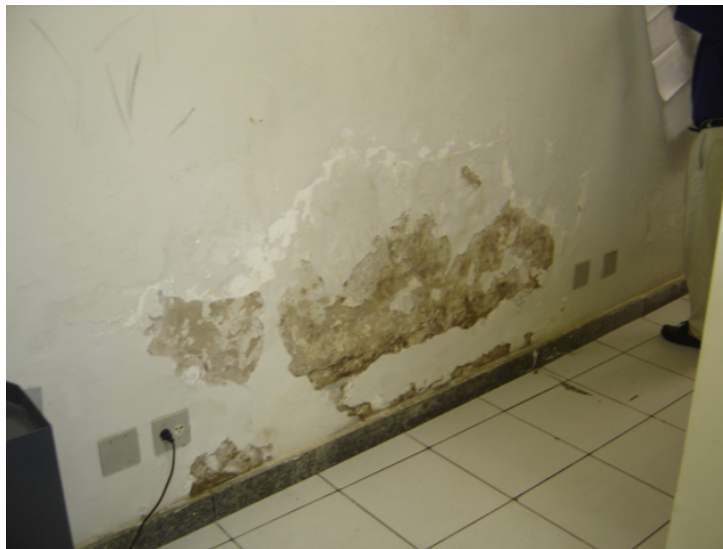
Figura 2.26 – Foto: Infiltração em parede devido a ruptura de tubulação
