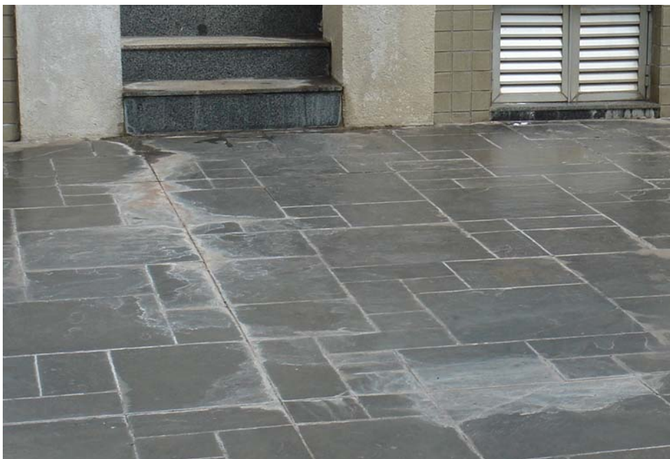
Figura 2.37 – Foto: Eflorescência em piso
